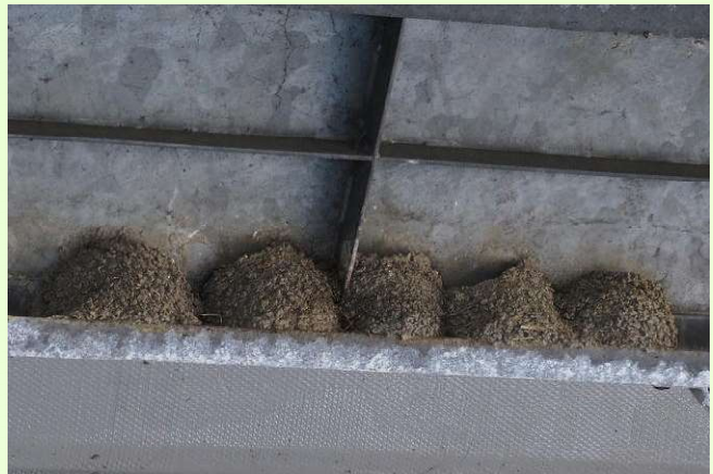
写真4 金属のコの字型空間を活かして造巣 中央自動車道 天竜川橋（下の図3のタイプ）
