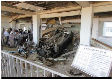
津波で校舎3階に車が運ばれた旧日向洋高校
